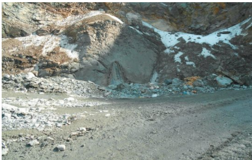
Рис. 3.3.18. Завершающая стадия возведения комбинированного искусственного целика вдоль борта карьера (закладочный массив возведён выше уровня кровли рудного тела)
